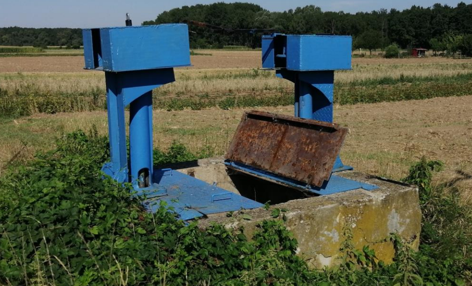
odběrný (nápustný) objekt
